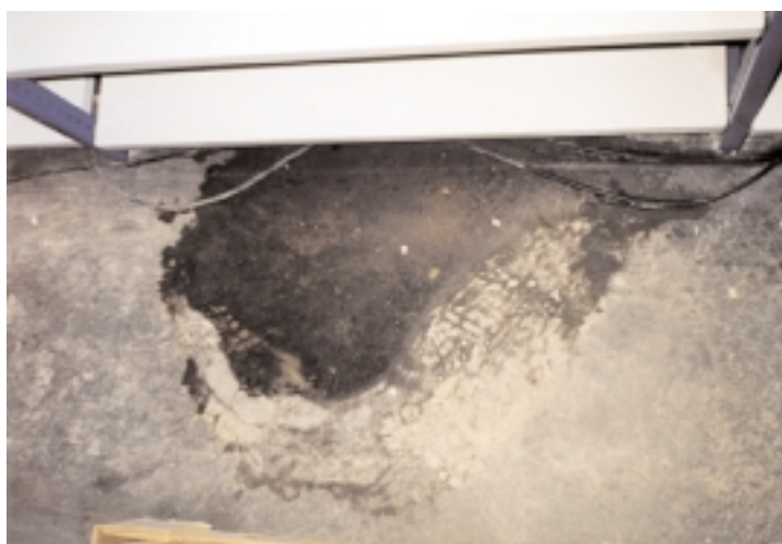
Humedad en el suelo
